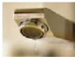
立即修理滴漏的水龍頭
