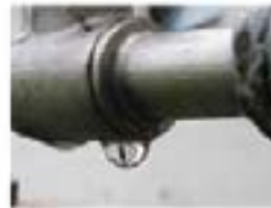
定期檢查家中水管有否滲漏
